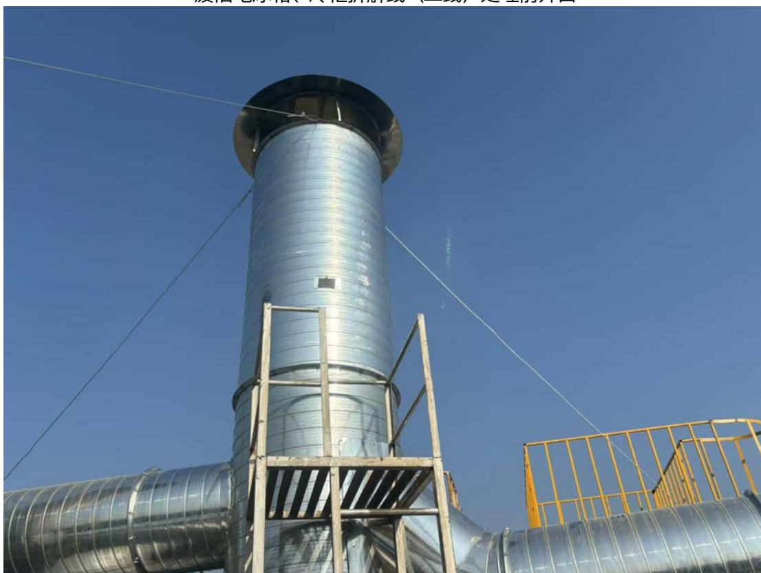
FQ-03088 处理后排放口
