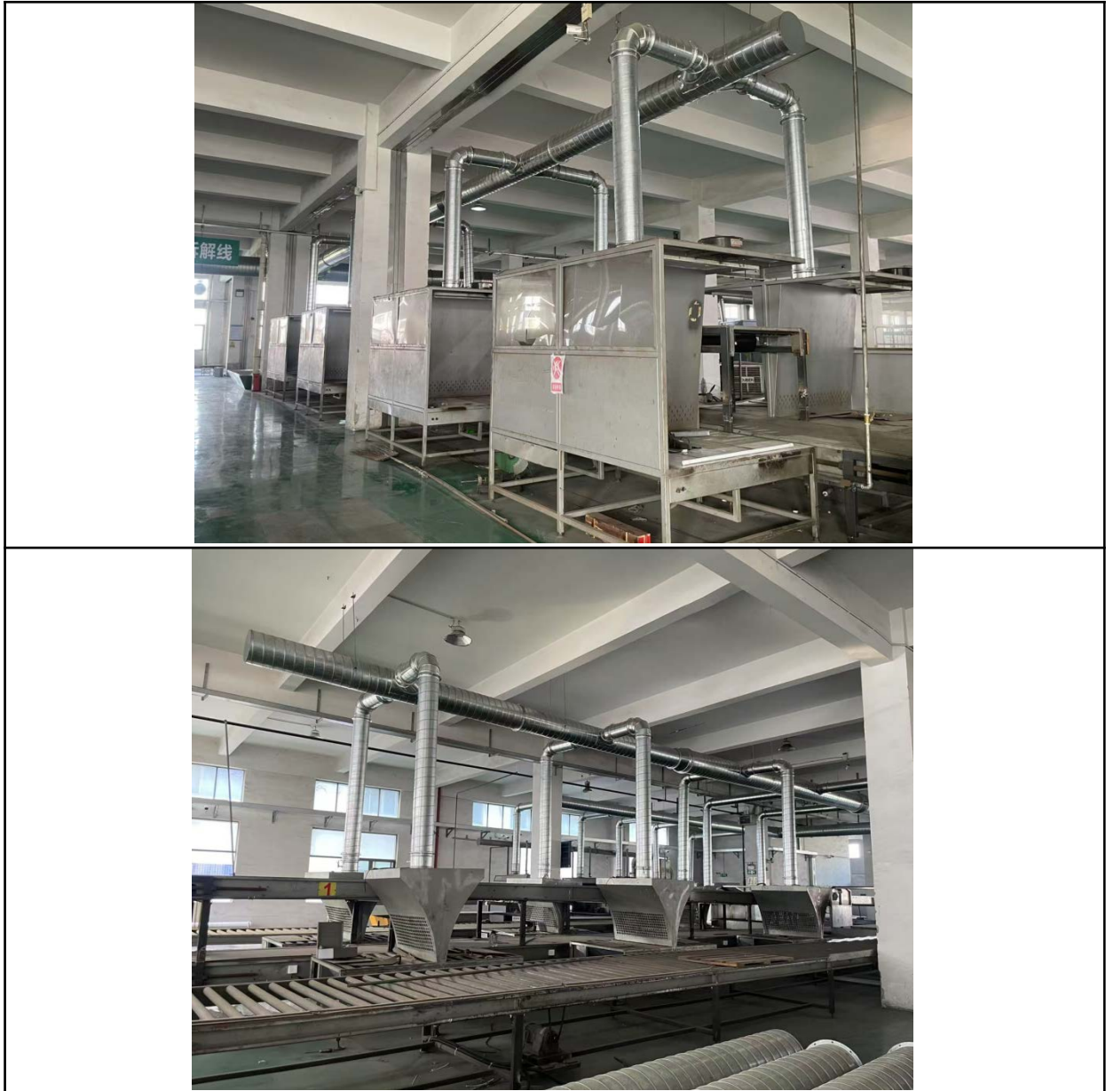
图 3.3-1 生产车间现场照片图
