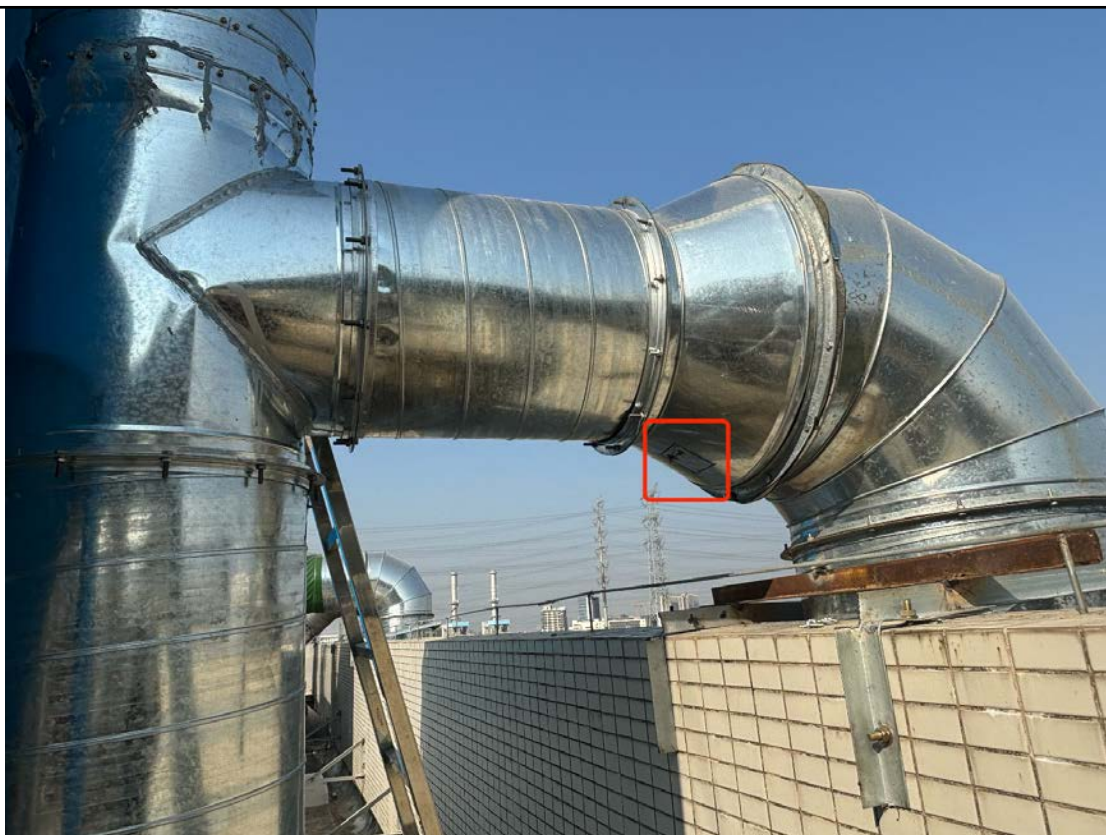
抽氟区废气处理前开口
