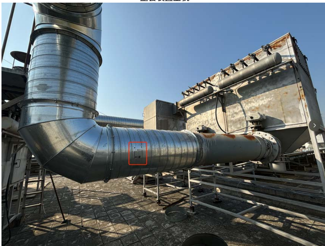
废旧空调拆解线（二线）处理前开口
