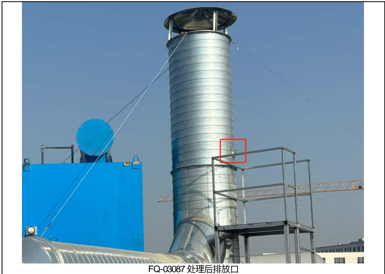
图 4.1-2 废气收集设施现场照片
