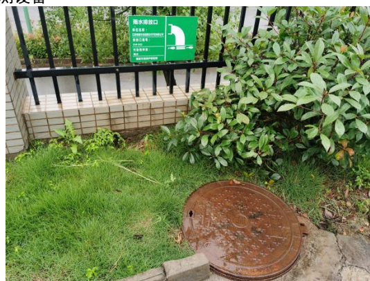
雨水排放口标识牌
