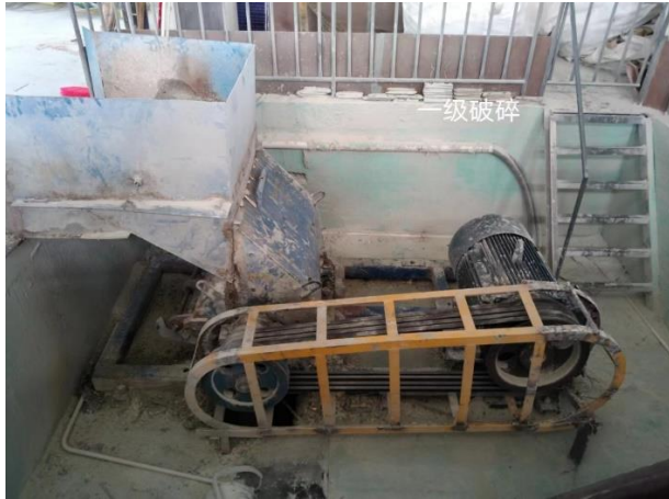
一级破碎机（本项目建设）
