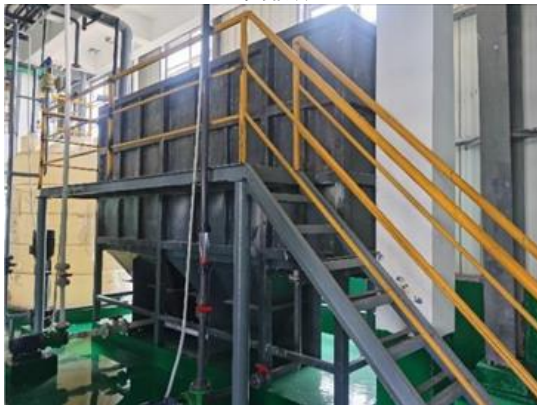
废水处理一体化设备（车间内）
