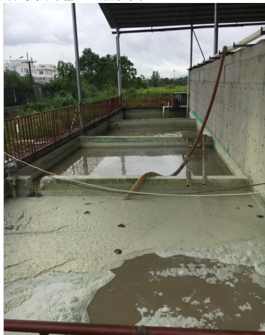
二级沉淀池+二级清水池
