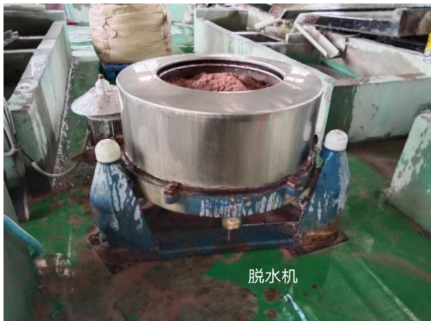
脱水机（本项目新建）
