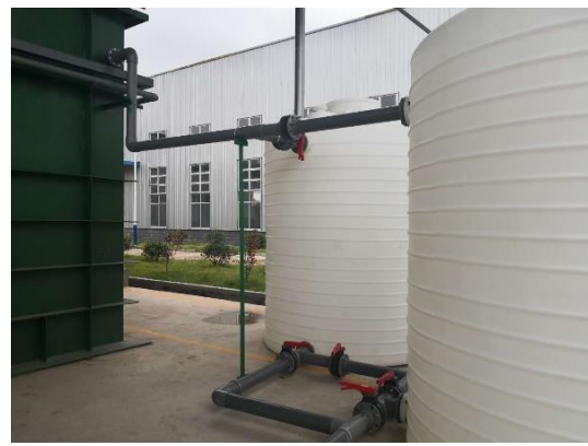
排放水管控设施
