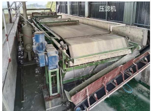
压滤机（本项目新建）
