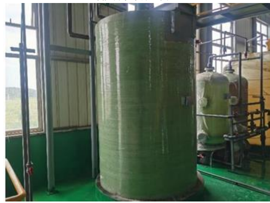
中和反应罐（车间内）
