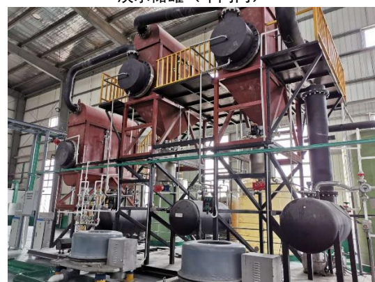
三效蒸发（车间内）
