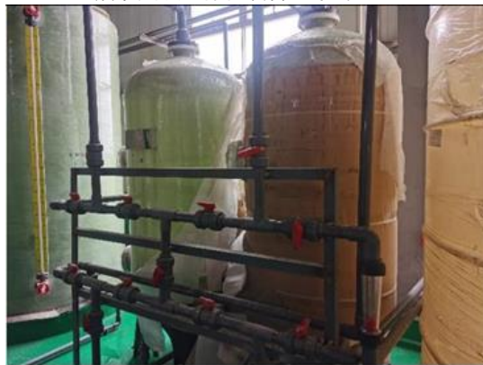
离子交换树脂（车间内）
