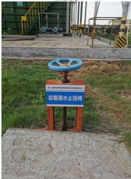
厂区初期雨水控制阀
