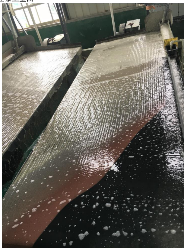
水力摇床（本项目新建）
