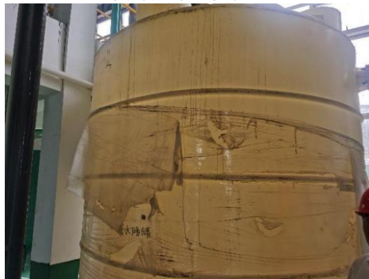
淡水储罐（车间内）
