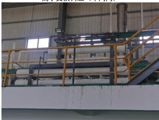
二级反渗透装置（车间内）
