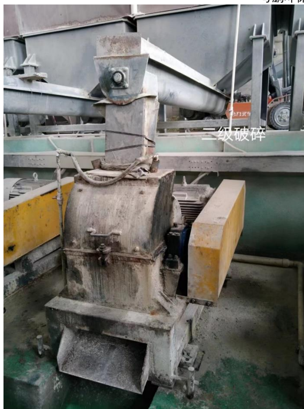
二级破碎机（本项目建设）
