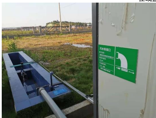
废水排放口标识牌
