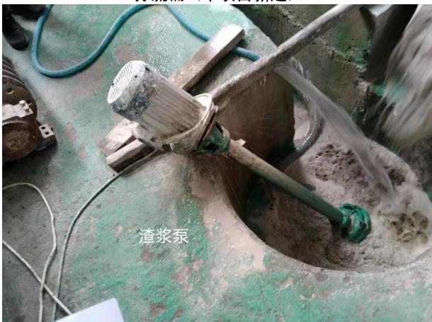
渣浆泵（本项目新建）
